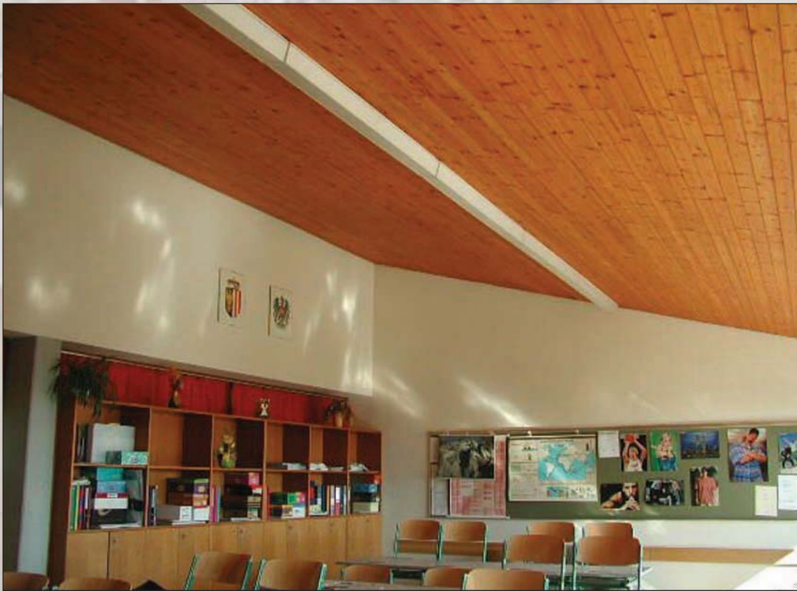
Abb. 10: Holzdecke mit hohen PCP-Konzentrationen in einer Schulklasse
