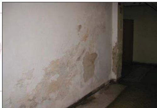
Abb. 17: Salzausblühungen in Folge eindringender Feuchtigkeit vom Untergrund
